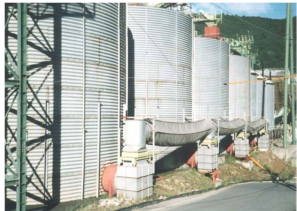
写真-3.8 細骨材気化冷却システムの全景（坂本ダム）
