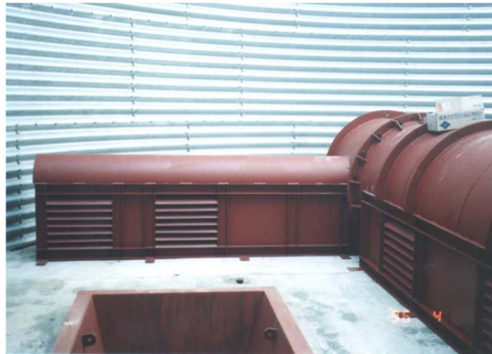
写真-3.9 気化冷却塔内部の冷風の吹き出し部の形状
