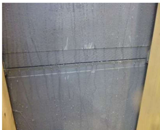
図 2-2-8 仕様A サイディング裏面全体の流れ出しの状況 (圧力差: 250Pa)
